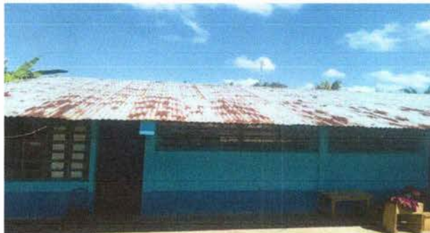
Foto 1: Láminas del techo de la escuela están deterioradas por esa razón hay que cambiar.
