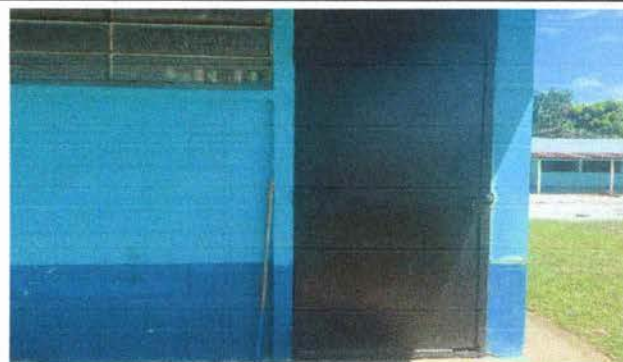
Foto 4: La puerta está en mal estado en la parte de abajo y por esa razón se va a comprar.
