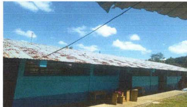
Foto 2: Láminas con oxidación por esa razón se realizará la compra de láminas troqueladas.
