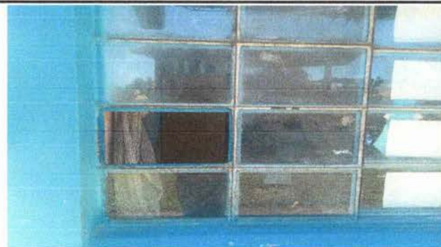
Foto 6: Cambios de vidrios de las ventanas de la escuela por que están quebrados
